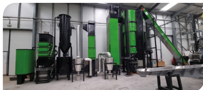
Figura 1 Vista geral do sistema de gaseificação de biomassas de leito fluidizado do Centro de Bioenergias do BioBIP.
