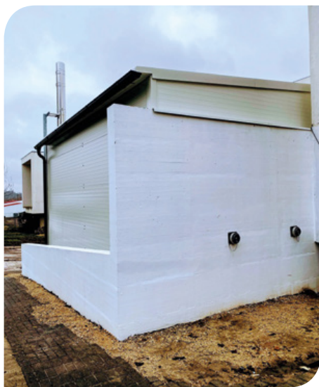
Figura 2 Central de produção de energia térmica SCIVEN, compatível com cogeração de eletricidade, alimentada a biomassa, instalada na Piscina Municipal de Montemor-o-Velho.
