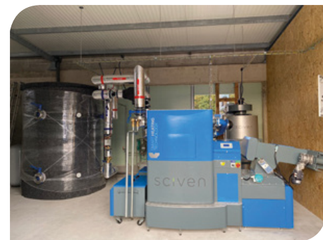
Figura 1 Central de produção de energia térmica SCIVEN, compatível com cogeração de eletricidade, alimentada a biomassa, instalada na Piscina Municipal de Vila Nova de Anços (Soure).
