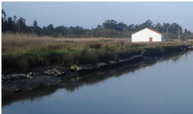
Figura nº 18 - Exemplo de degradação de margens
