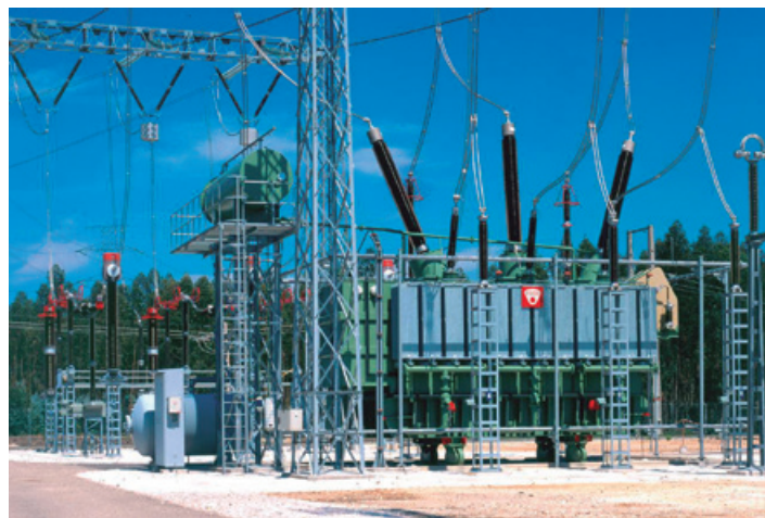
Figura 2. Subestação da RNT equipada com transformador de potência Efacec.
