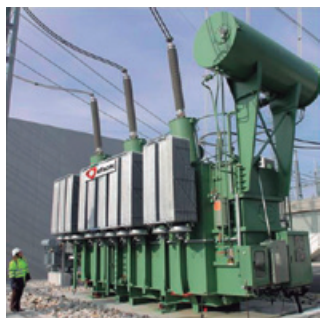
Figura 1. Transformador de potência da RNT.
