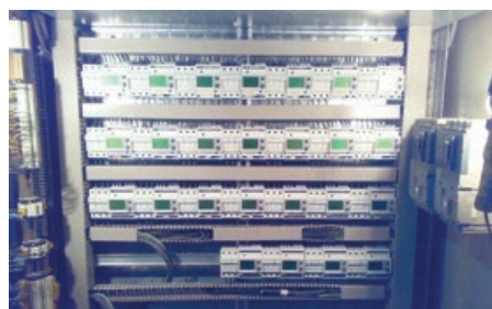
Figura 1. Sistema de análise de consumos de energia instalado numa Central de Trigueiração.
