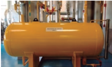
Figura 7. Reservatório de líquido.
