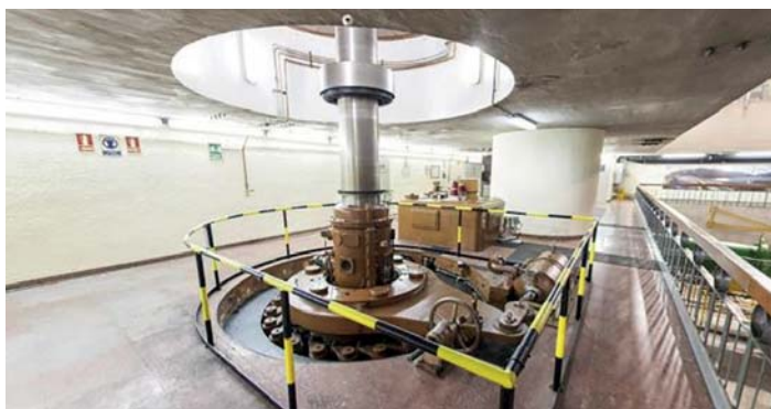
Fotografia 1. As centrais elétricas baseiam grande parte de sua rentabilidade na manutenção adequada. Na figura aparece um grupo hidroelétrico (fonte Enel Green Power Hydro, Endesa Generacion).
