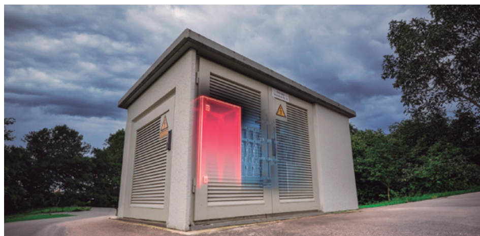
Figura 2. Postos de transformação compactos e inteligentes tornam possível a transição energética (armário compacto AX da Rittal).
