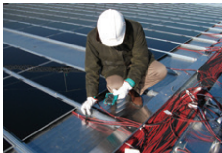
Figura 3. Medição da corrente DC de strings de painéis solares.
