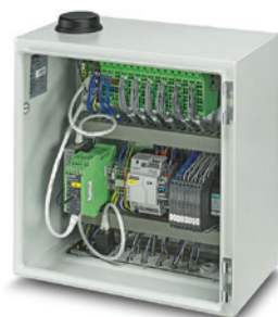
Figura 3. Exemplo de um quadro elétrico com um router 3G. Destaque para a antena instalada na superfície do quadro elétrico.
