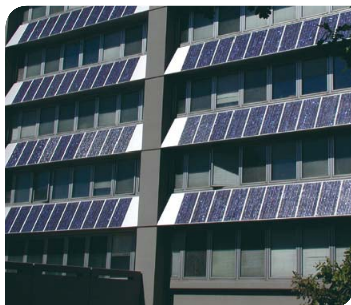
Figura 3 Sistema fotovoltaico integrado numa fachada de um edifício em Genebra. Fonte: https://www.flickr.com/photos/us-mission/3881123643
