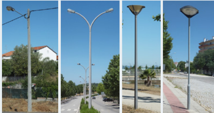
Figura 5.9 – Postes e colunas de iluminação
