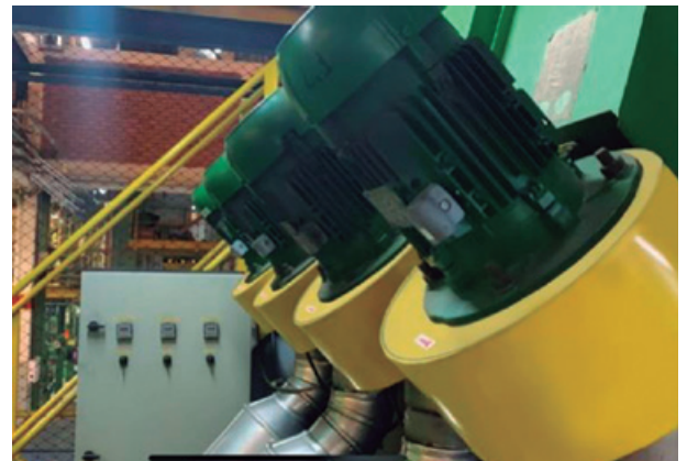
a) monitorização de motores elétricos.
