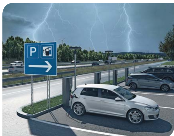
Figura 1 Proteção contra tempestades: os postos de carregamento têm de funcionar de forma segura e fiável qualquer que seja o estado do tempo.
