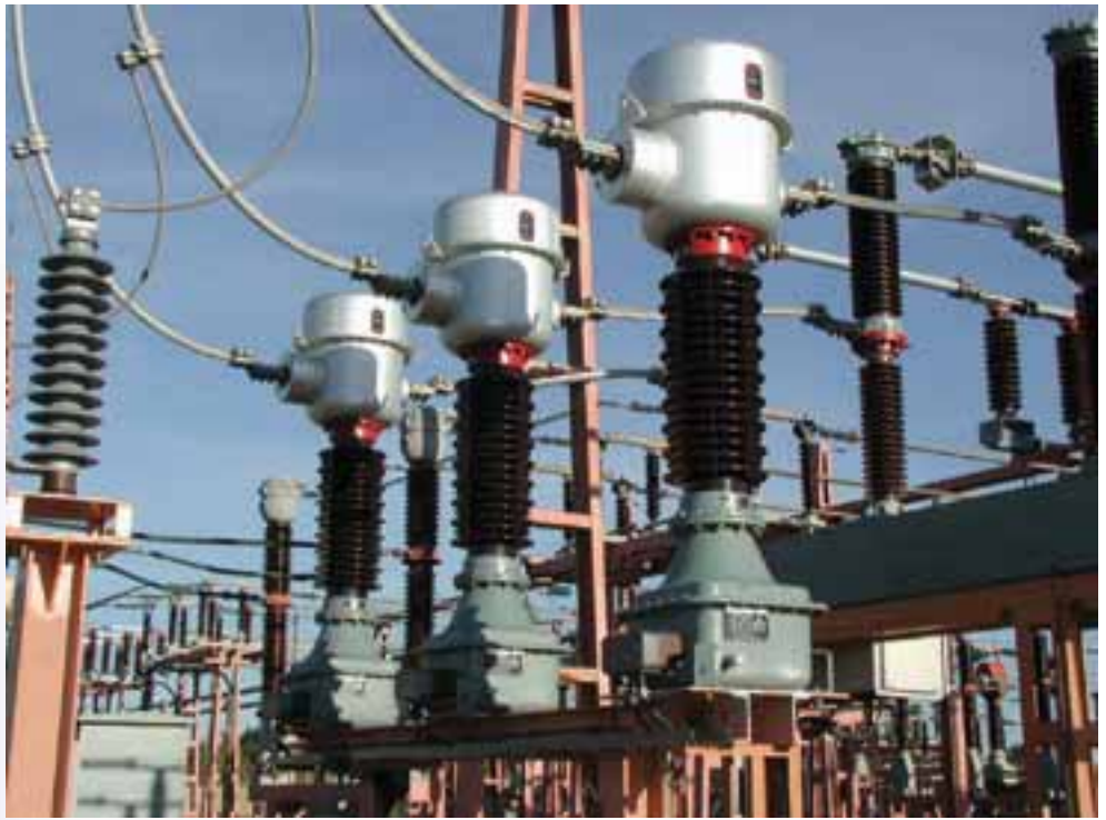
Transformadores Combinados de 72 kV en entrada de línea de subestación. L'ONE (Marruecos). Temperaturas entre -10° y +50° C.
