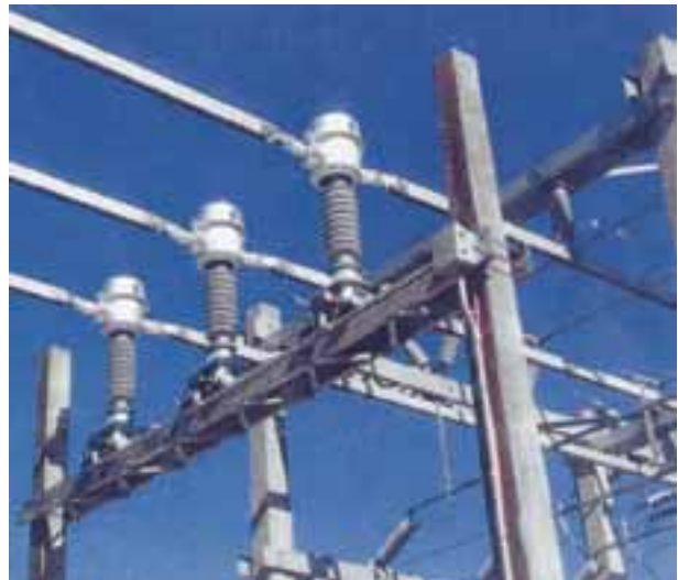
Transformadores Combinados de 69 kV en punto de medida. Greenville Ligth & Power Systems (USA).
