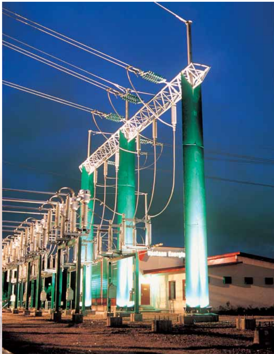
Transformadores de Intensidad 123 kV. Vantaan Energia. Finlandia.
