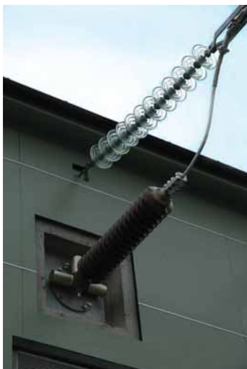
APPE - 145 Transformador pasobarra. Interior - exterior. Subestación de distribución.
