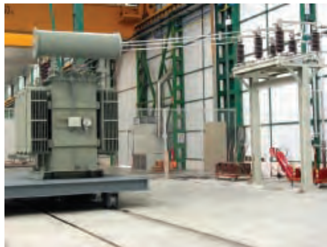
Ensayo de cortocircuito Short-circuit test
