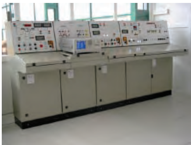
Pupitre de mando Laboratorio de Potencia Operation desk High Voltage Laboratory
