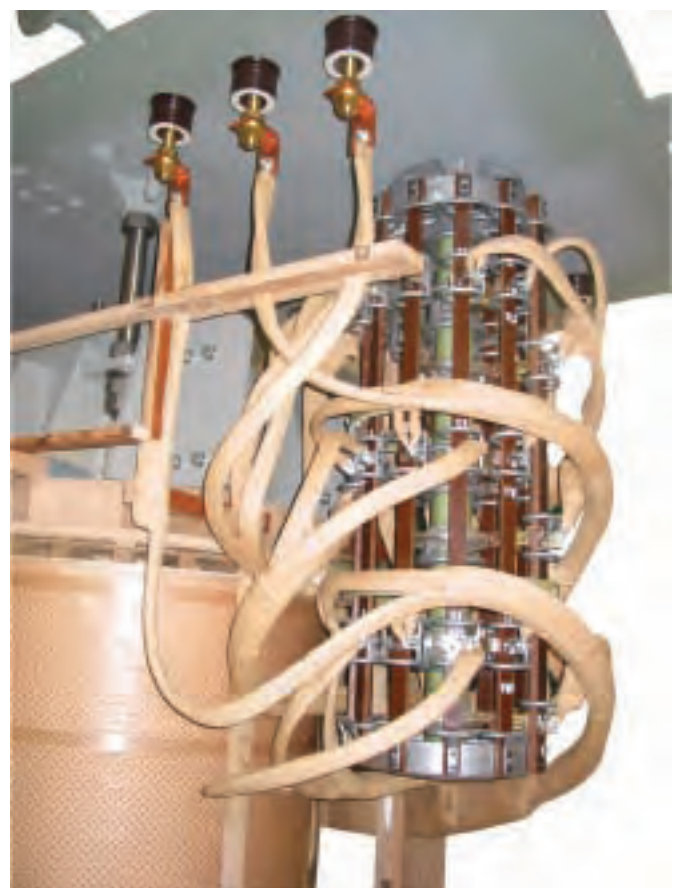
Conexiones regulador Transformador 40 MVA
