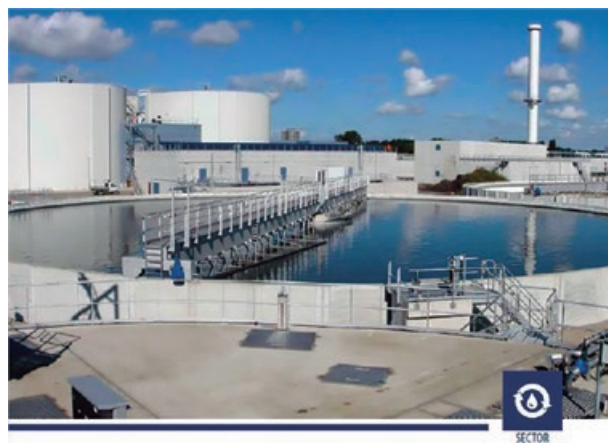
Figura 2. Estação de tratamento de águas.
