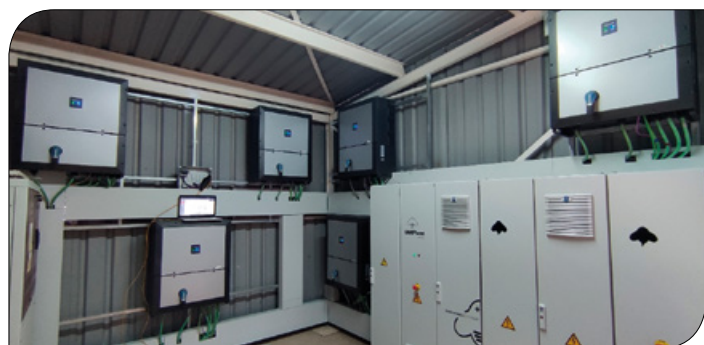
Figura 1 Interior do edifício com a instalação dos inversores de armazenamento Ingeteam 3play 100TL e 100TL juntamente com as baterias Beeplanet Factory.
